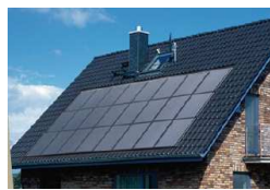
Production électrique photovoltaïque
